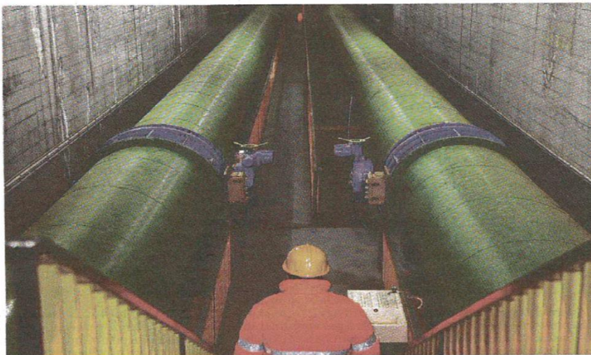
Condotture dell'acquedotto Smat di Torino
